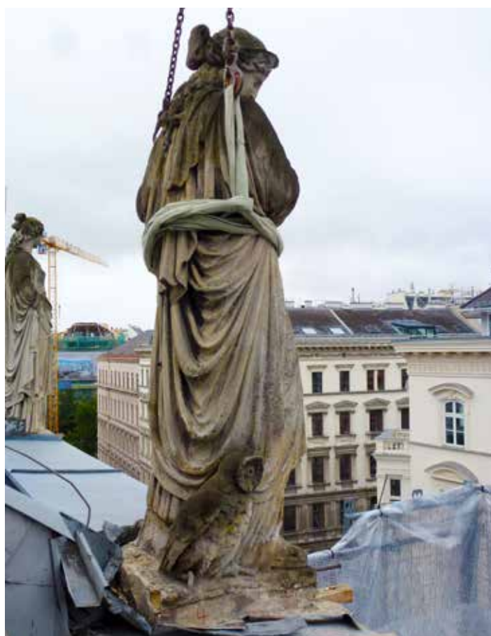
Die Attikafiguren zeigen starke Verwitterungsspuren und müssen umfassend renoviert werden (Foto: ÖIAV)
